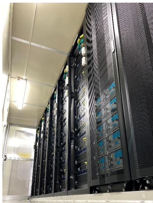
データセンター内部写真
